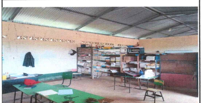
Foto 4: Se observa que en otra de las aulas no tiene división de concreto
