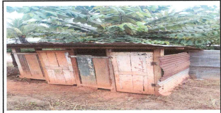
Foto 1: Se observa el mal estado de las letrinas
