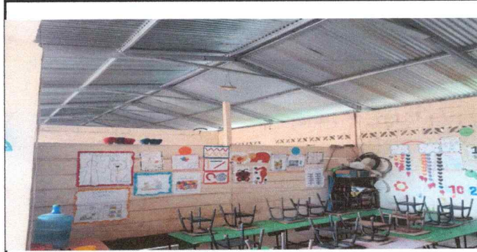
Foto 3: Se observa que en una de las aulas no cuenta con divisiones de concreto
