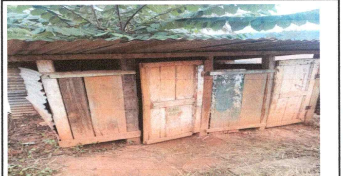
Foto 2: Se observa las letrinas que estan forradas con laminas viejas y madera vieja.
